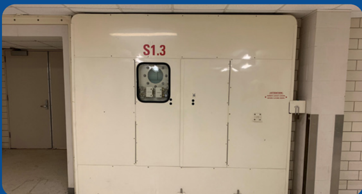
Cellule étanche de protection contre les dommages causés par les eaux de crue
