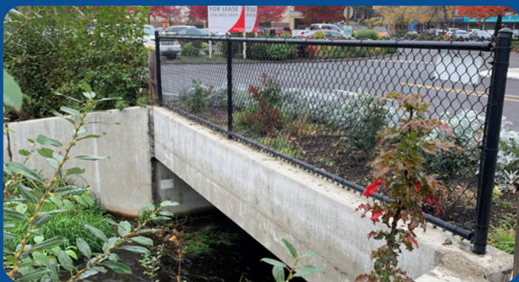
Ponceau muni d'un mur de tête protégeant contre l'érosion et permettant le passage de l'eau sous une route
