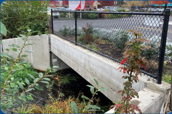
Kanal mit Schutzwand, die Erosion verhindert und Wasser unter Strasse durchfliessen lässt
